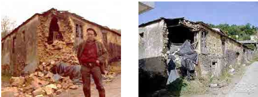
Fig. I.5.47. Imágenes de los daños en una vivienda de Guilfrei, en Becerreá (Lugo) en 1997 16
