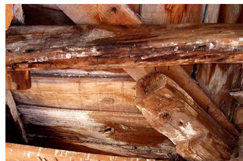
Aspecto de la madera dañada
