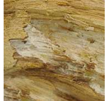
Aspecto de la madera dañada.
