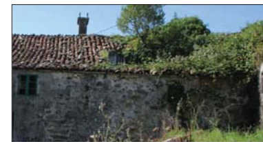
01 ZONA DERRUMBADA NORTE
