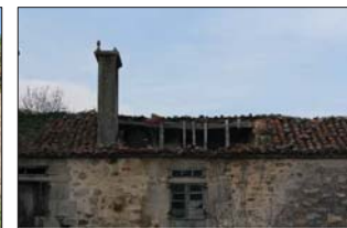
02 ZONA DERRUMBADA SUR
