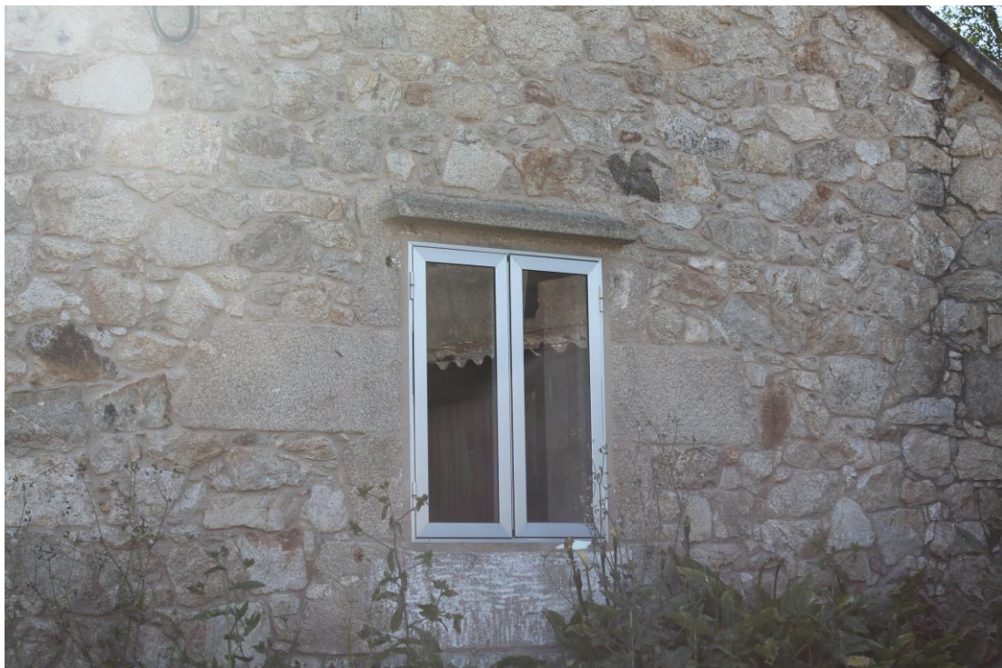
Fachada lateral derecho: referencia del tamaño de las piedras para jambas y dinteles.
