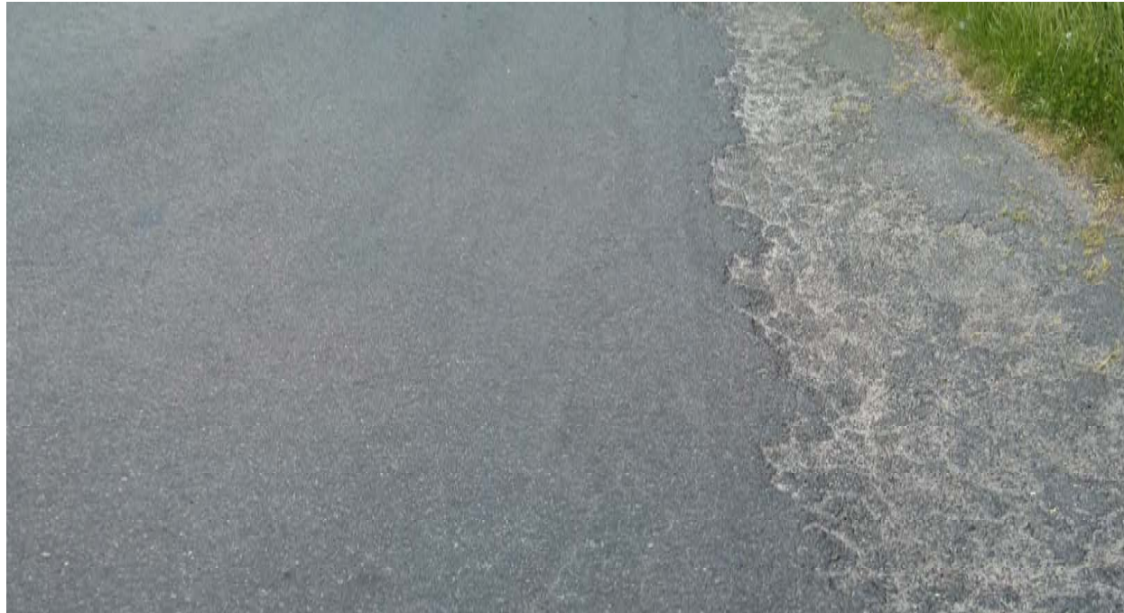
Foto 9. P.K 5+355. Estado del firme.
