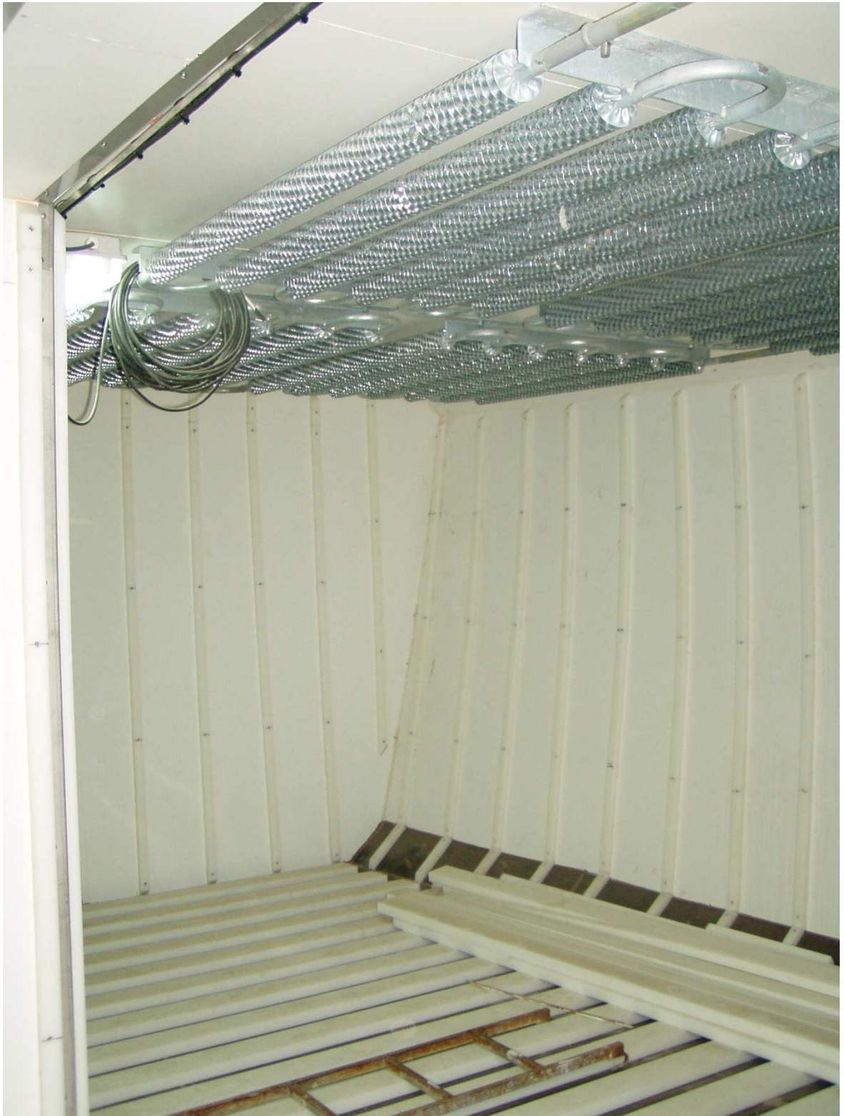
Figura 2.3.3.3.1.- Imagen real de los serpentines de la bodega del buque
