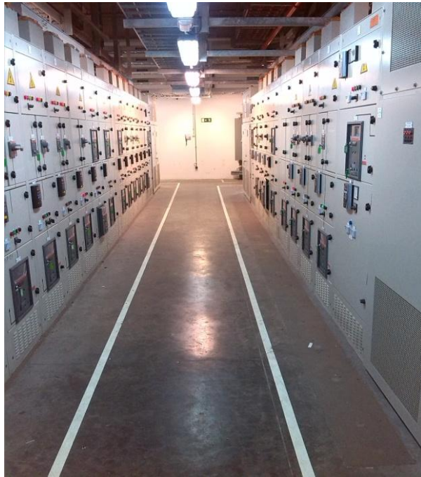
Figura .2.4.3-Sala eléctrica de cota 0
