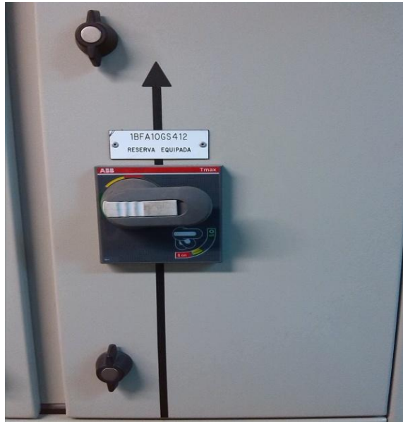
Figura .2.4.4-Interruptor de alimentación a la planta frigorífica.
