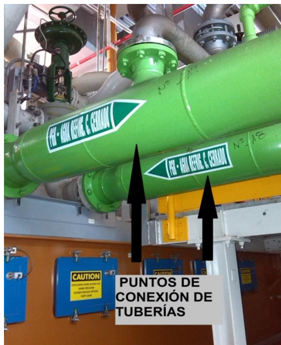
Figura .2.4.2-Punto de entronque de tubería PGB con sistema de refrigeración de la planta frigorífica.
