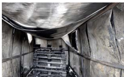
i16. Efecto del fuego en las chapas metálicas.
