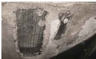
i13. Efecto spalling en el hormigón.
