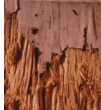
Fotografía 21: Aspecto de la madera dañada
