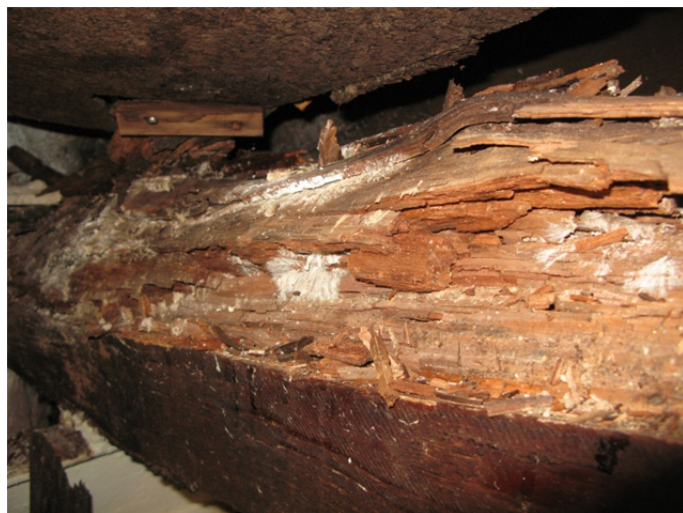
Fotografía 20: Aspecto de la madera dañada
