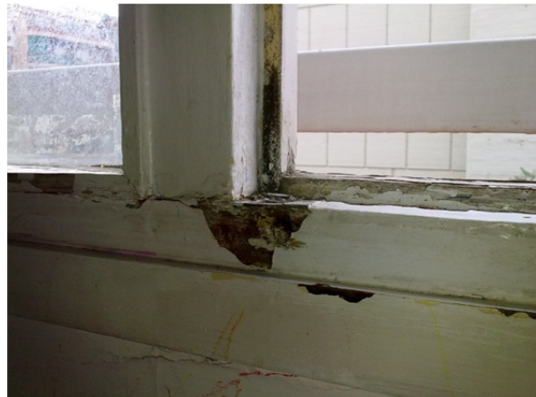
Fotografía 22: Aspecto de la madera dañada.
