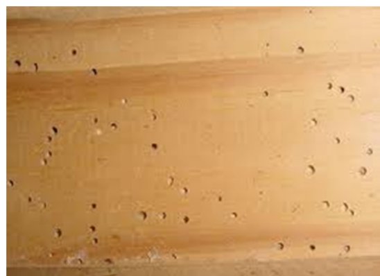
Fotografía 27: Daños producidos en la madera
