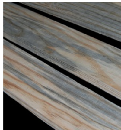
Fotografía 23: Aspecto de la madera dañada.
