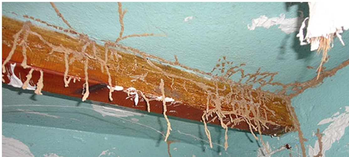
Fotografía 28: Pequeños canales formados por las termitas
