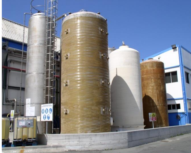
Figura 4. Depósitos fijos con cubeto de seguridad para el almacenamiento de sustancias corrosivas.
