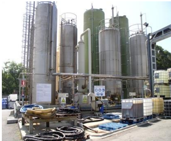
Figura 5. Parque de almacenamiento de sustancias inflamables.
