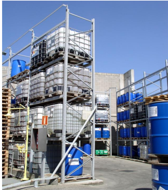
Figura 6. Sistema de almacenaje en estanterías para sustancias peligrosas envasadas en contenedores, bidones o barricas.
