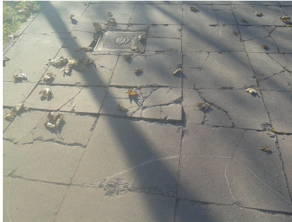
Figura XVII: Pavimento con mal mantenimiento
