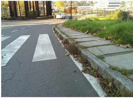
Figura XX: Bordillo sin rebasar y con mal mantenimiento
