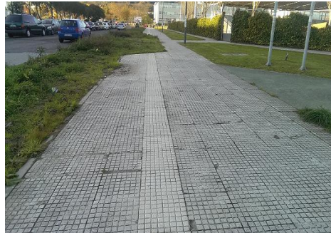
Figura XVIII: Pavimento diferenciado sin sentido
