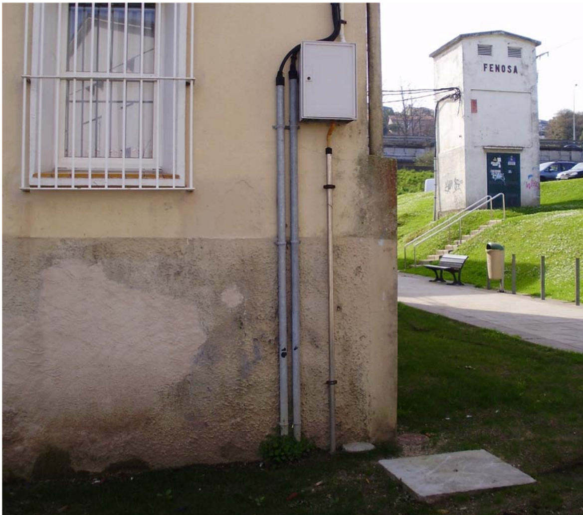
Acometida del bloque nº 12 a la red de gas natural.
