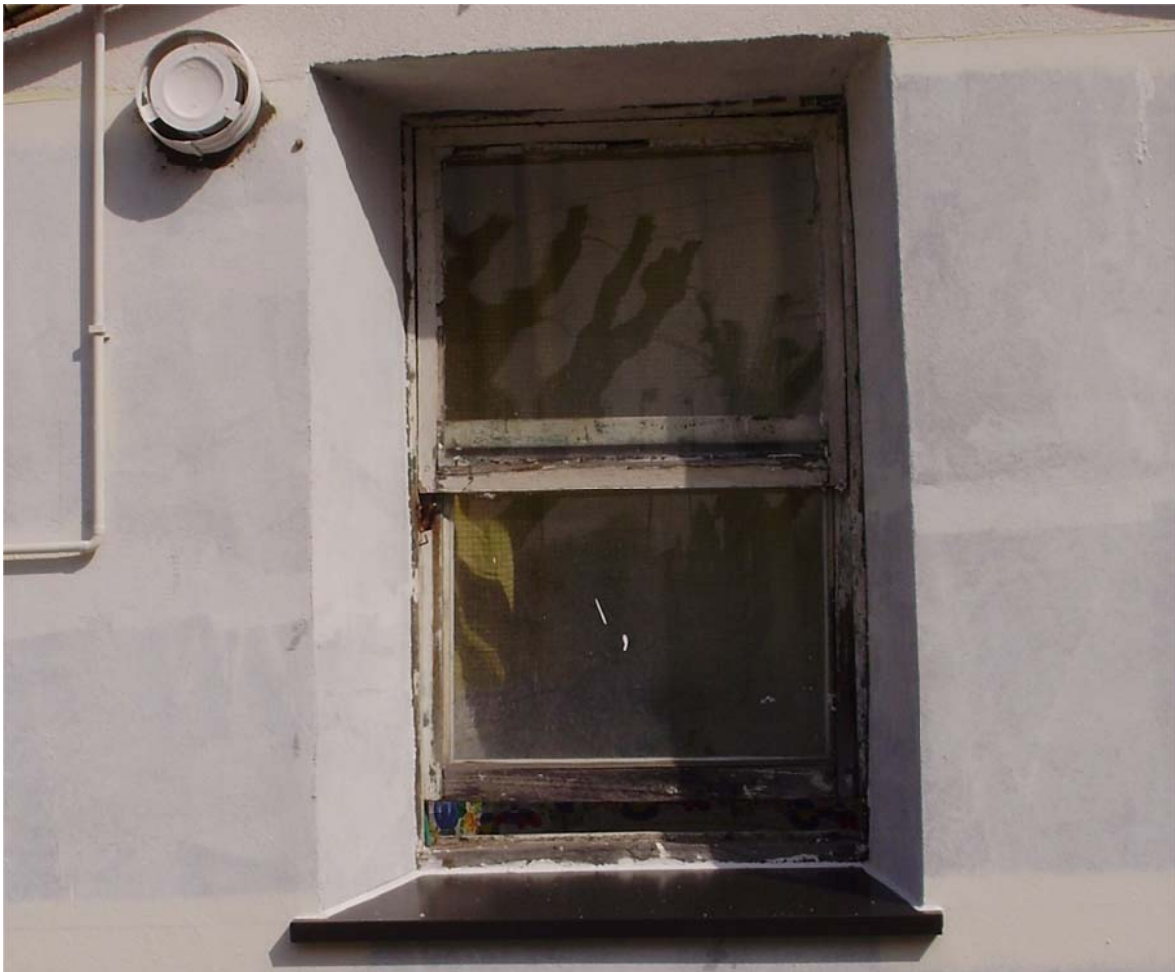
Ventana de carpintería de madera muy deteriorada.
