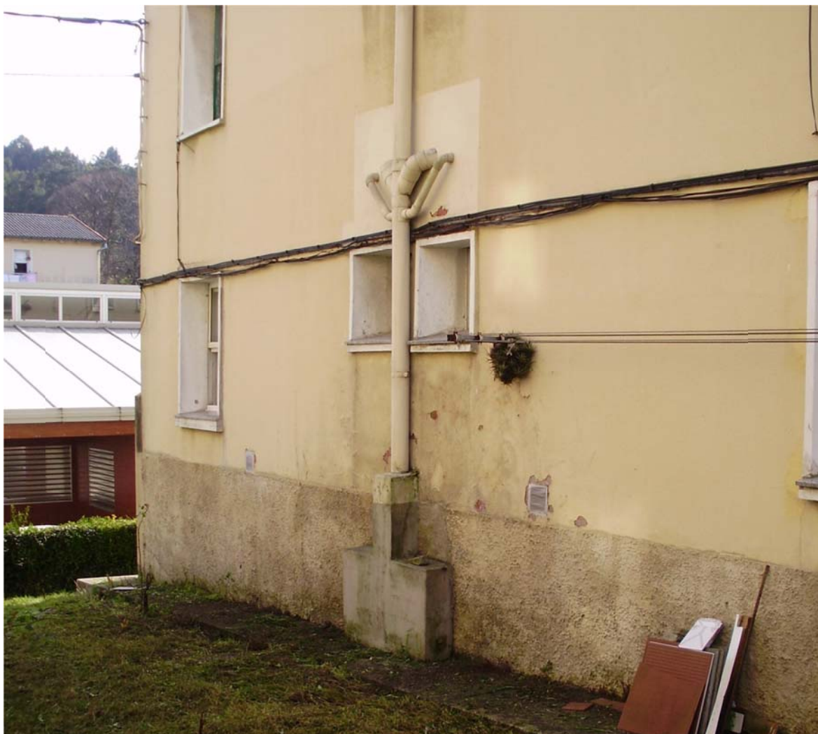
Bajante en la que se aprecia el cambio de tonalidad de la pintura al sacar los desagües al exterior.
