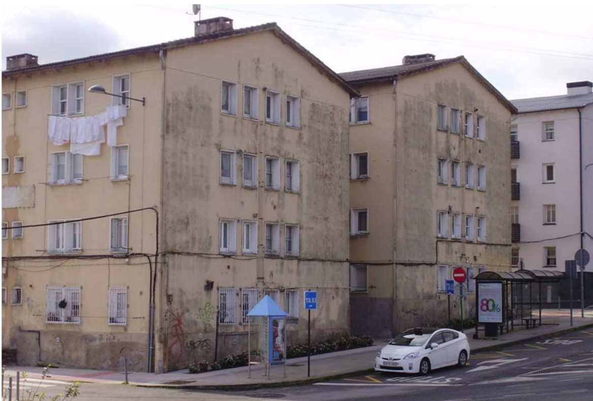
Bajantes de pluviales en las esquinas del bloque nº 1.
