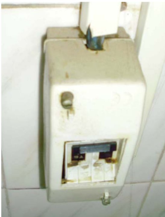
Interruptor magnetotérmico como única protección de la instalación eléctrica.
