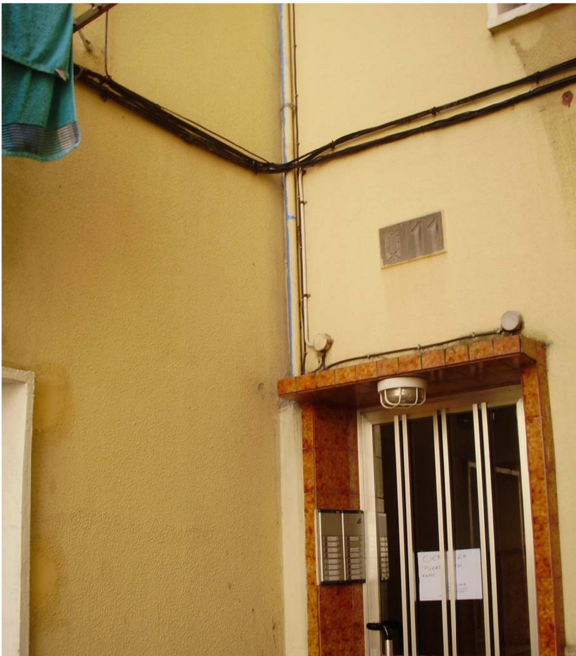
Canalización exterior de agua en el bloque nº 11.
