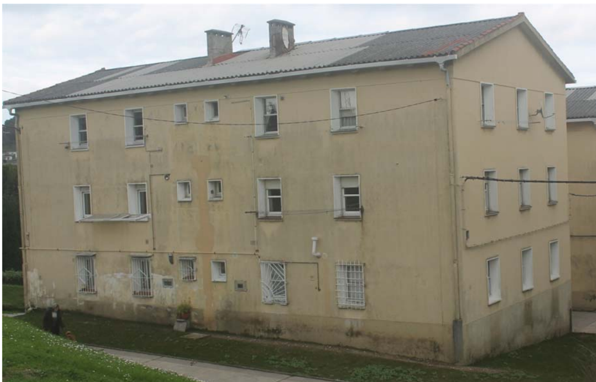
Chimenea de extracción de humos en el bloque nº14.
