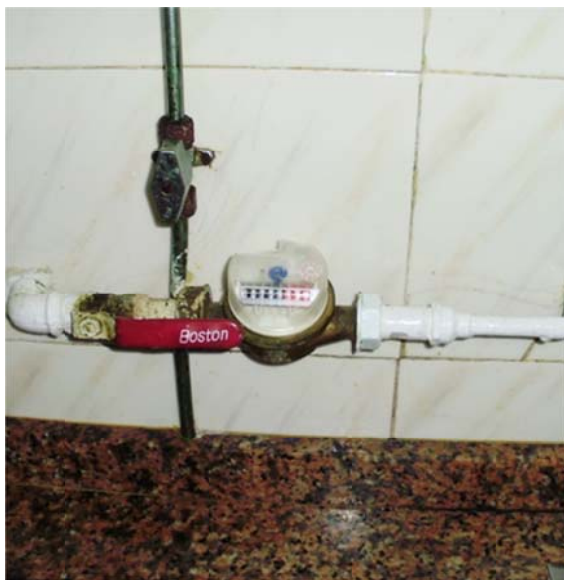
Contador en interior de vivienda
