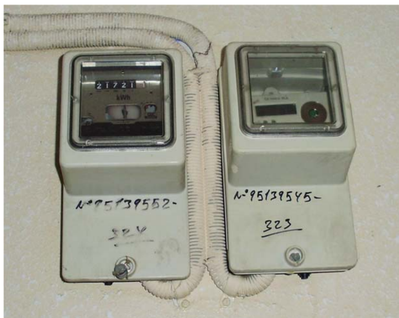
Contador individual de los pisos 323 y 324 en el bloque nº 11.
