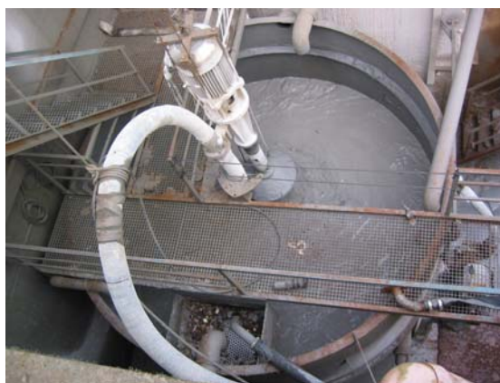
Figura 2.4. Tanque bajo telar para recirculación de lodos
