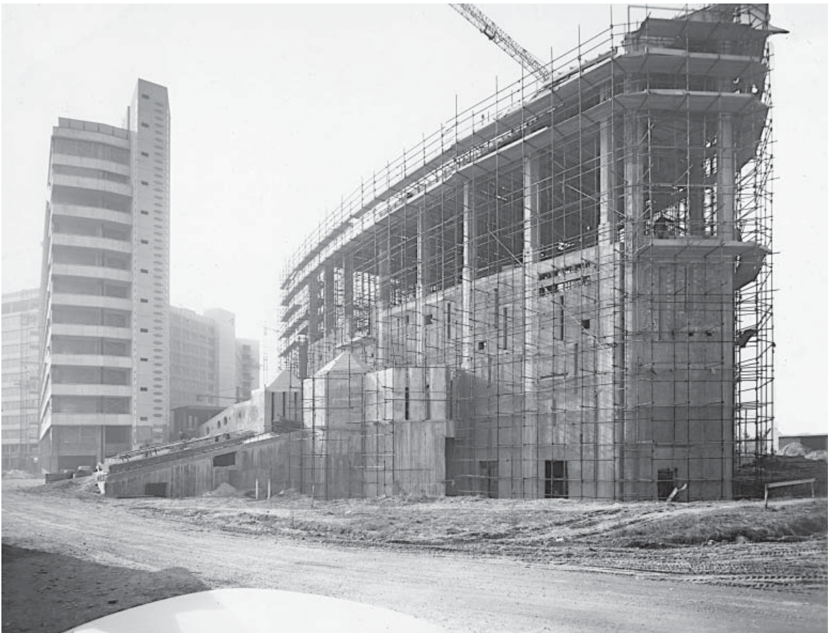
Fig. 13. Estructura portante de hormigón armado y capillas vistas desde el lado sur de la iglesia (febrero 1965).
