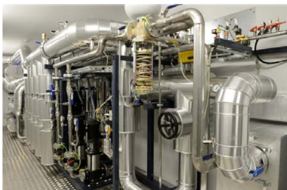
Figura 5: Contenedor de servicios
