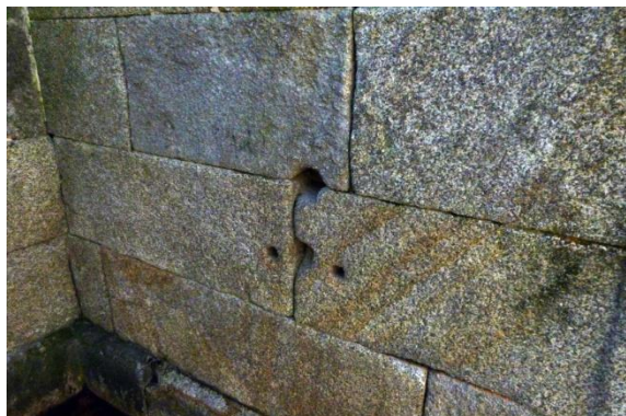
IMAGEN 45: PERFORACIONES EN MURO
