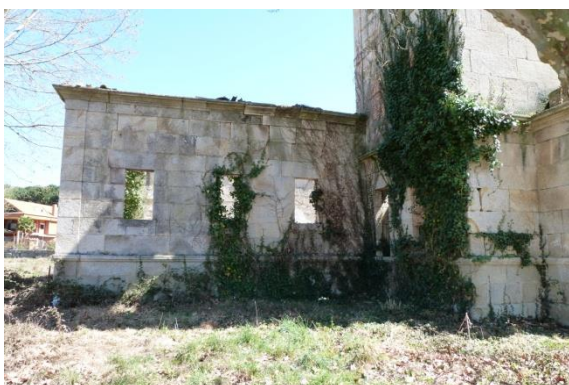
IMAGEN 16: FALLO MURO SUOESTE
