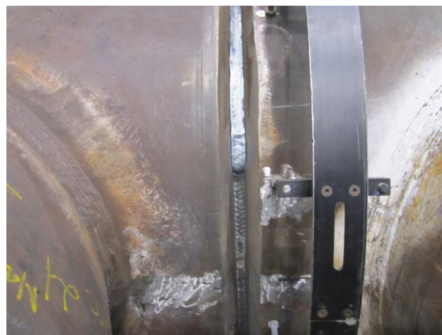
Figura 25: Aspecto de la soldadura orbital realizada a los tubos de la figura 27 (Fuente: Revista de Metalurgia)
