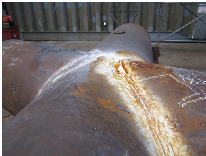
Figura 86: Nudo x-bracing de injertos de igual diámetro en taller con aplicación de cutback (Fuente: Propia)
